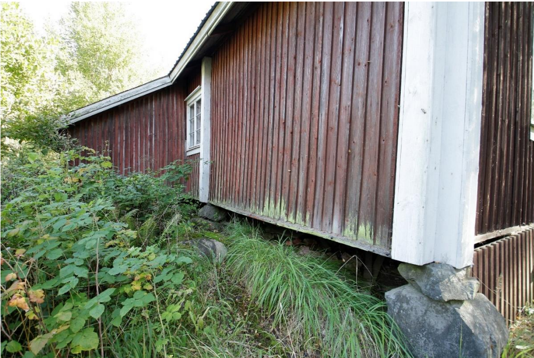
Kuva 136 Hirsirakennuksen ympäristö on kasvamassa umpeen ja rakennuksen nurkat ovat hieman painuneet.
