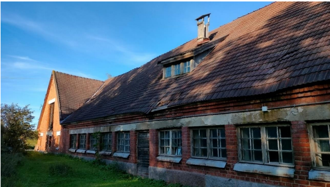
Kuva 106 Suuren tiilinavetan länsijulkisivu. Navetan ikkuna-aukot on holvattu betonipalkilla, perustuksina on käytetty porakiviä. Navetan vesikate on heikossa kunnossa ja kattorakenne on paikoin painunut.
